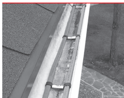
6 водосборные лотки (водосборные желоба)
