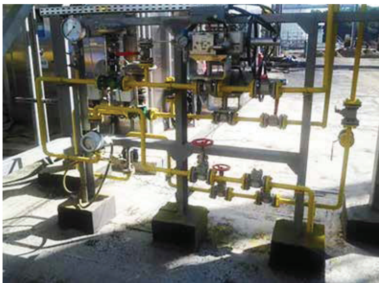
Фото участка обогреваемого трубопровода.
